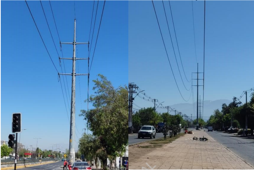
FIGURA N° 2-6 Líneas de Alta Tensión de 110 KV en Av. Grecia y Los Molineros
