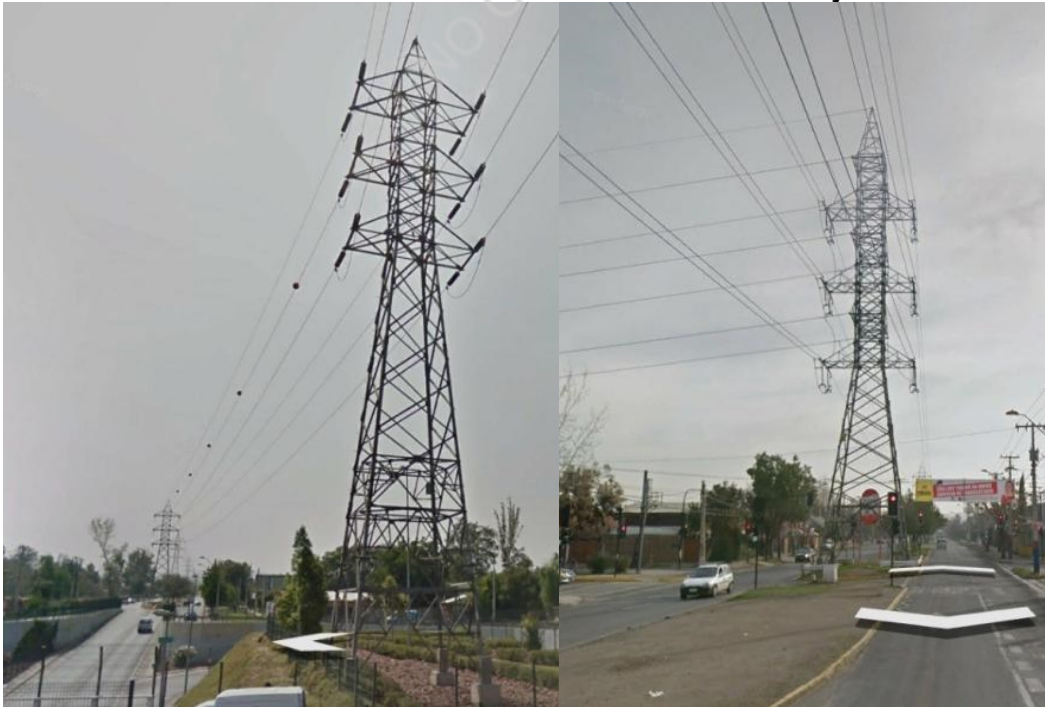
FIGURA N° 2-7 Líneas de Alta Tensión de 110 KV en Av. Las Torres y Av. Tobalaba
